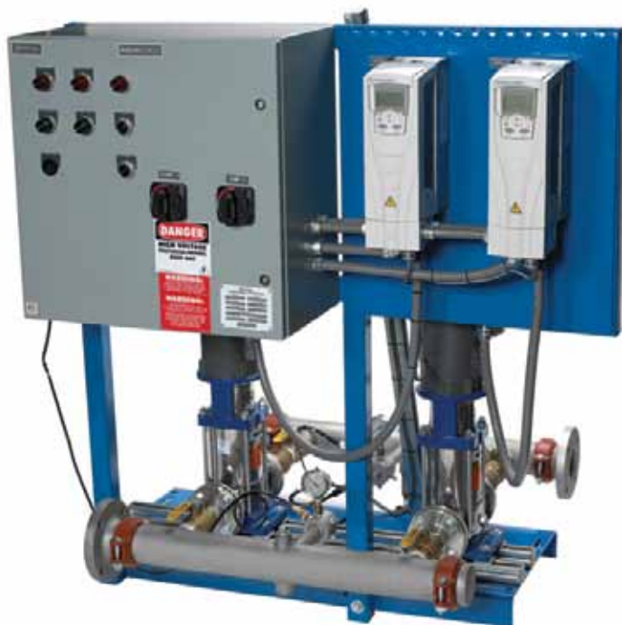
Stations de pompage ouvrées
